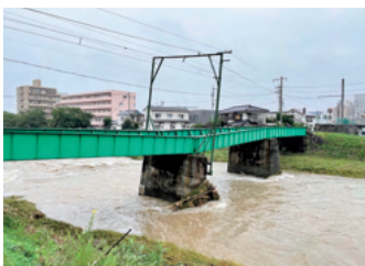
大雨により橋脚が傾いた上高地線
