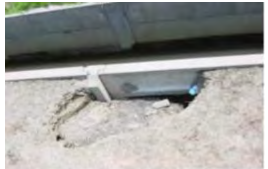
水路側壁の空洞状況
