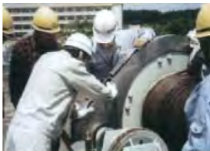
ポンプ点検状況
