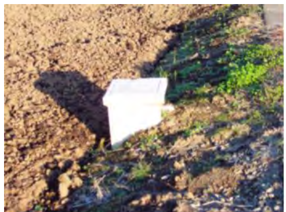
傾いた給水栓ボックス
