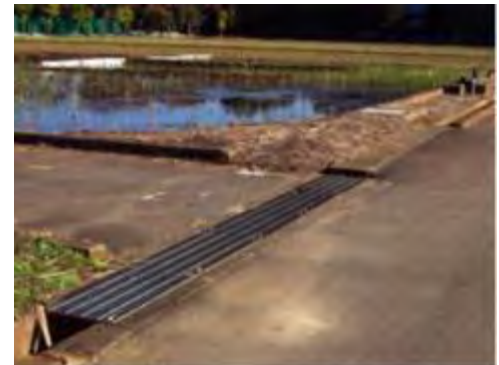
コンクリート蓋とグレーチング
