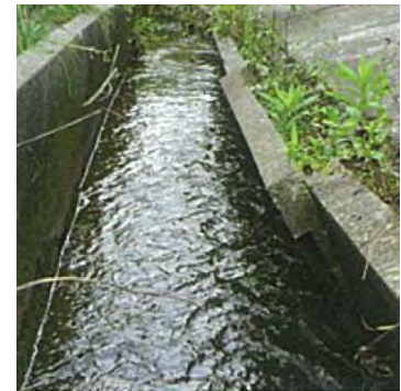
側壁の倒壊（側溝）
