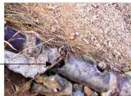
古い樋管（陶製）の破損
