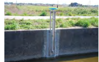
巻き上げ式ゲート（分水用ゲート）
