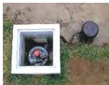
給水栓の自動化
