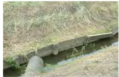
水路側壁のはらみの状況
