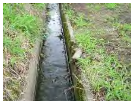
破損したU字溝
