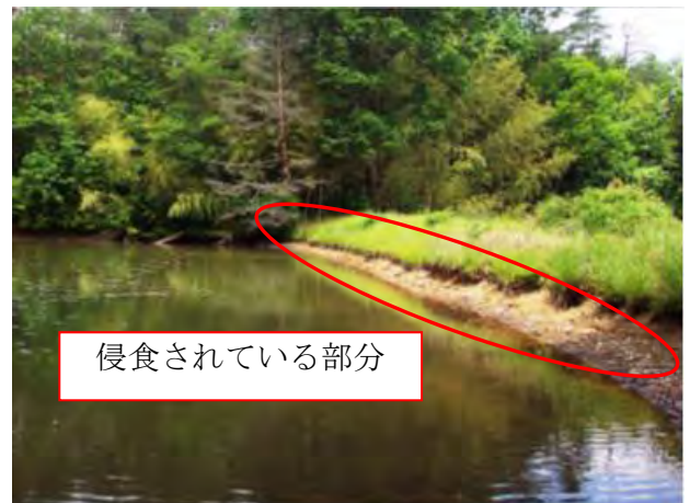
侵食が生じているため池堤体
