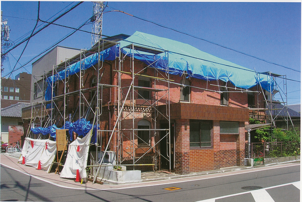
倒壊防止のために設置された足場及び屋根瓦崩落のためのシートによる養生
