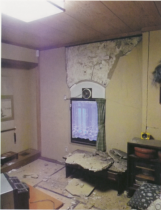
2階北西和室の北面アーチ上の漆喰壁の剥落
