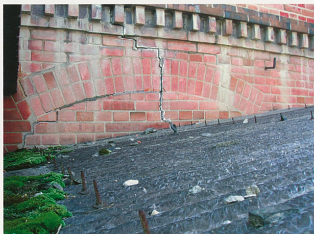
1階東面の旧入口部分の亀裂
