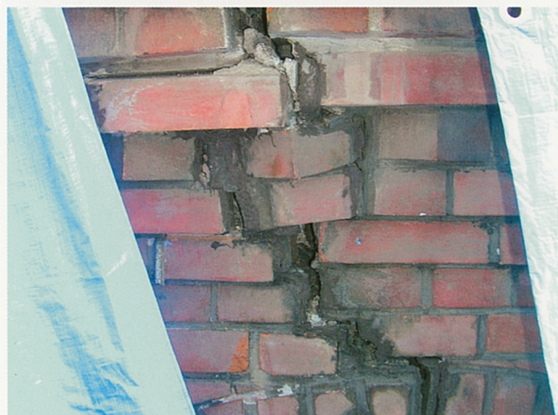
2階西面南側アーチ上の亀裂
