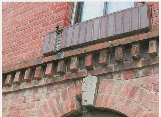
1階南面東側アーチ部の煉瓦、2階同窓台タイルの崩落
