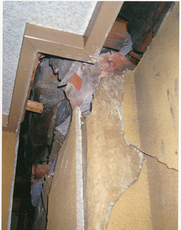
2階南壁のはらみ出しによる天井部の開き
