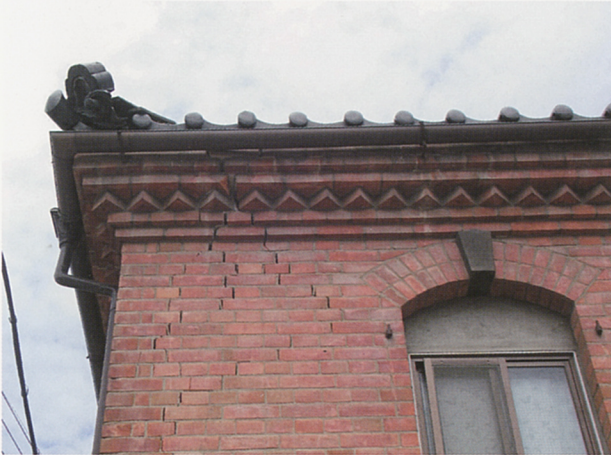
2階東面南隅の亀裂
