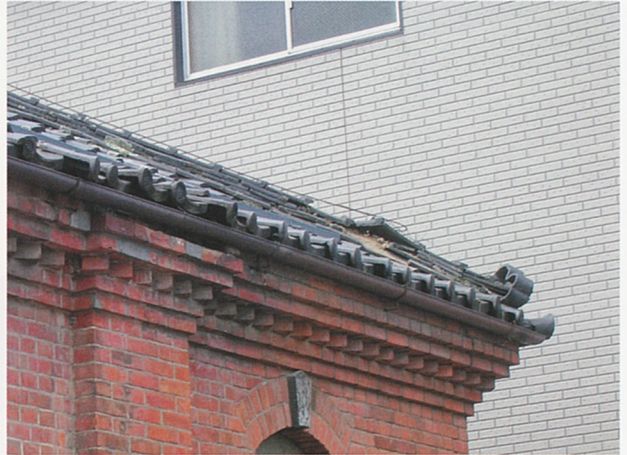
北西隅棟部分の屋根瓦の崩落
