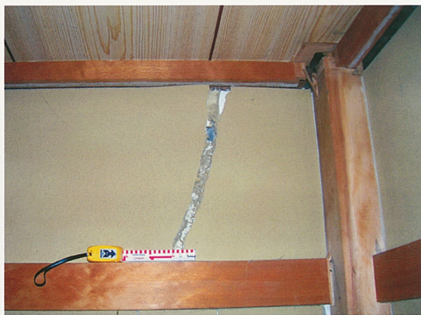
2階東面南隅の亀裂（室内）
