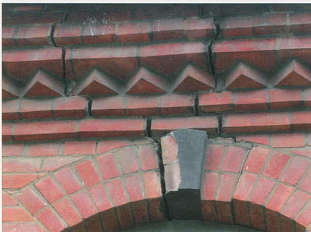
2階東面北側アーチ上の亀裂
