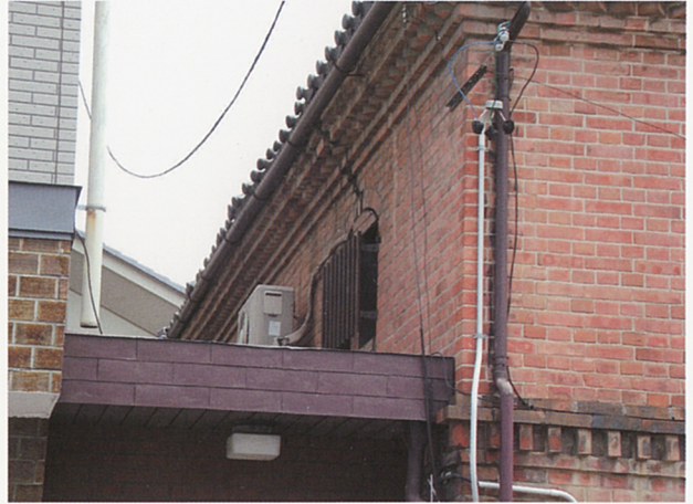
2階西面南側アーチ上の亀裂
