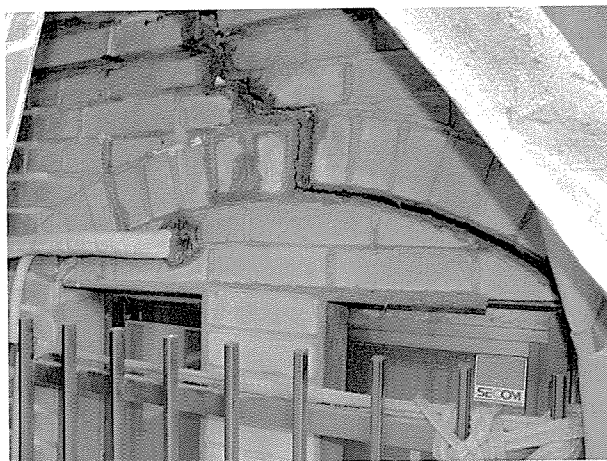
写真11 西面2階アーチ上部のクラック
