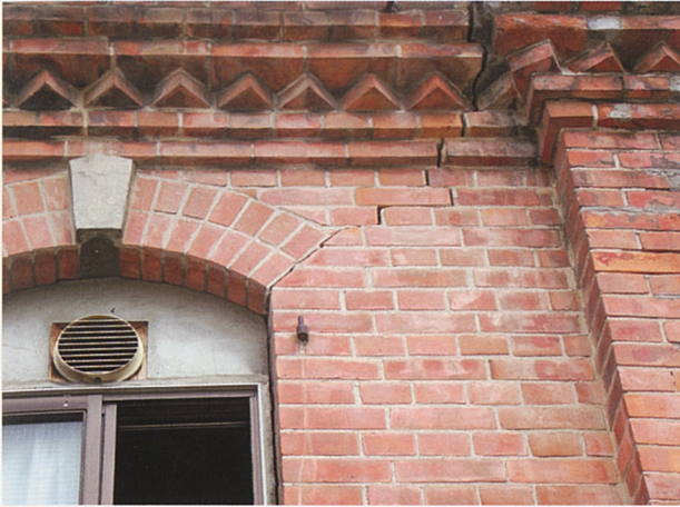
2階南面西側アーチ上の亀裂
